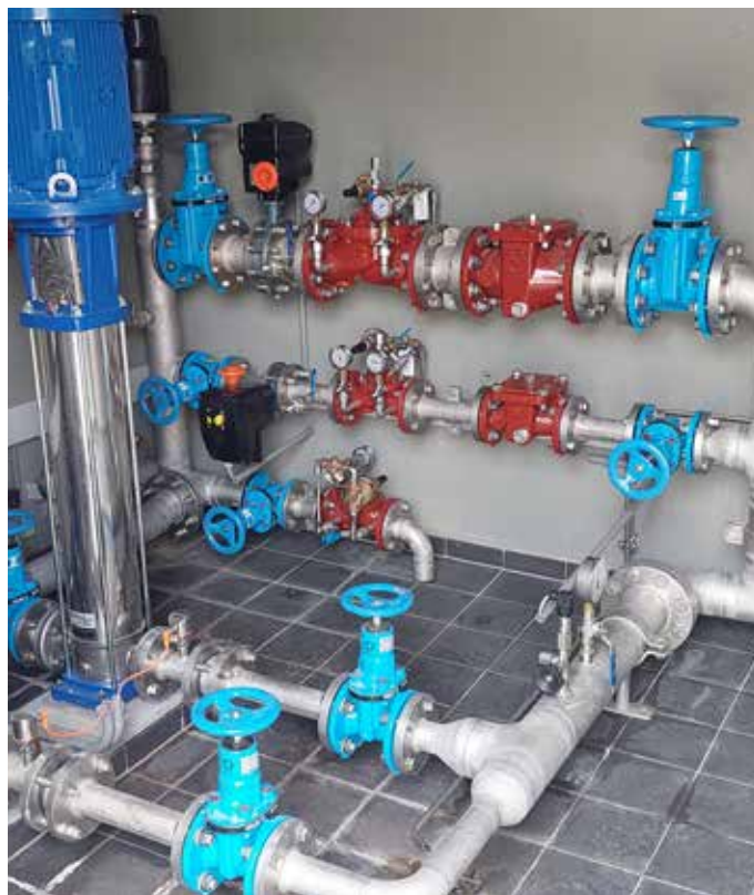
Pumpen und Druckreduzierung Bonacker Kapelle (Pumpwerk 2)
