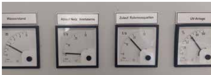
Überwachung Hochbehälter Innerlaterns
